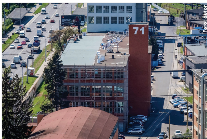
Firma ZPS – Frézovací nástroje sídlí v jedné z budov Baťova areálu v centru Zlína. Momentálně probíhá renovace pláště budovy, která má za cíl mimo jiné snížit energetickou náročnost.
